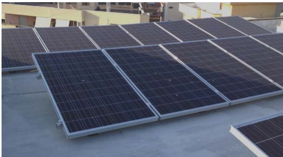
impianto fotovoltaico installato su una copertura
